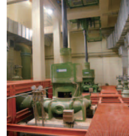
Estación de bombeo de aguas residuales intermedia en Dubai, EAU
